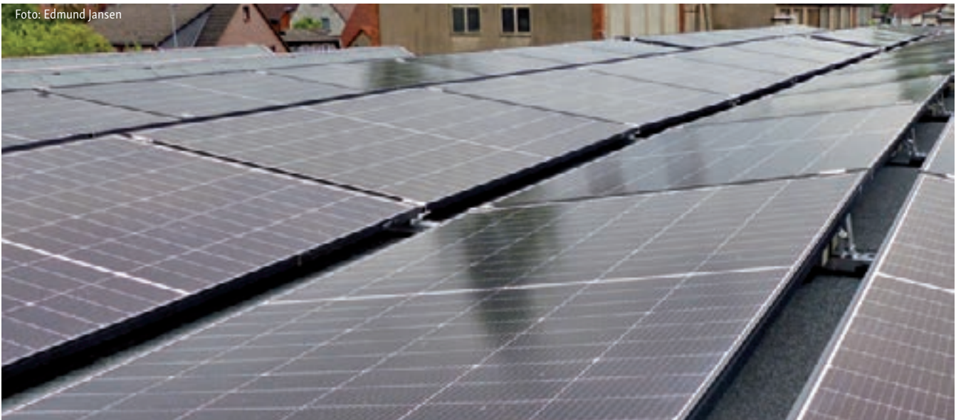
PV-Anlage auf der Kulturfabrik Krawatte, installiert durch die Energiegenossenschaft Calenberger Land (ENER:GO)
